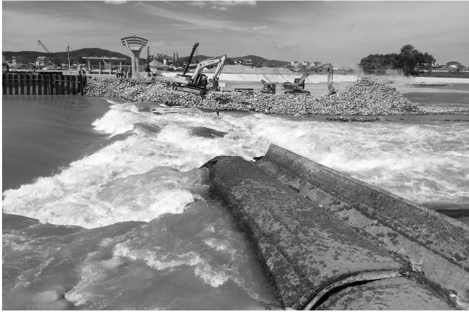
●Đập dâng xã Tràng Sơn, huyện Đô Lương, tỉnh Nghệ An gặp sự cố trong quá trình thi công.
